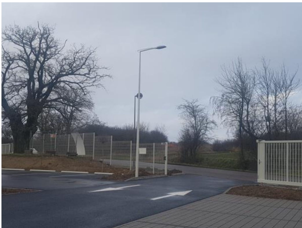
Mat d'éclairage entrée du complexe
